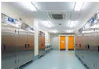
奥はエアシャワー・両側は保管機
